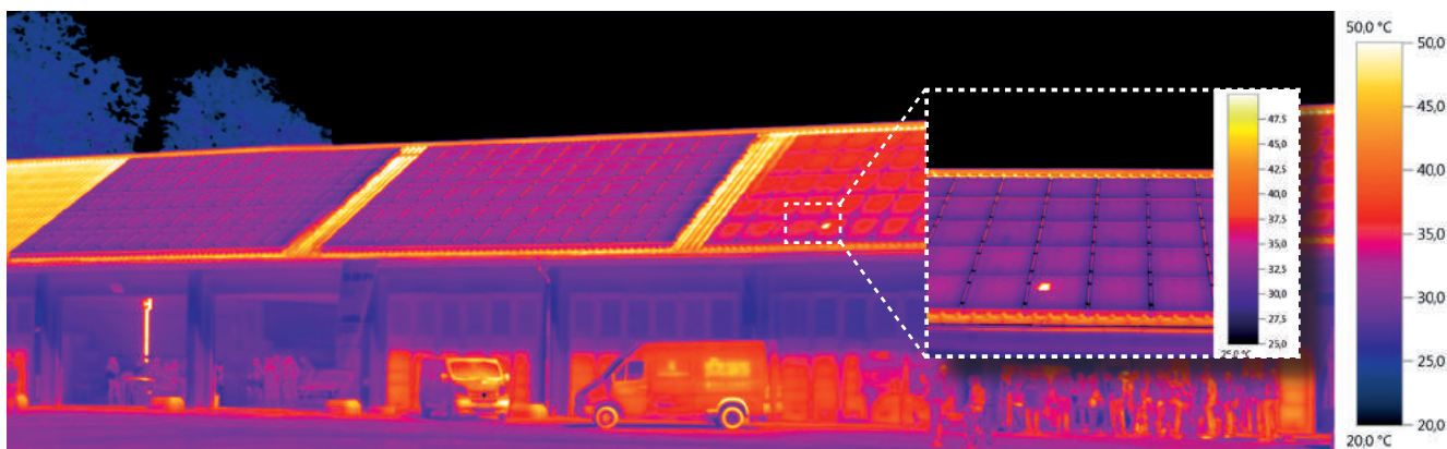
Immagine panoramica dell'impianto fotovoltaico e analisi dettagliata con il teleobiettivo.
